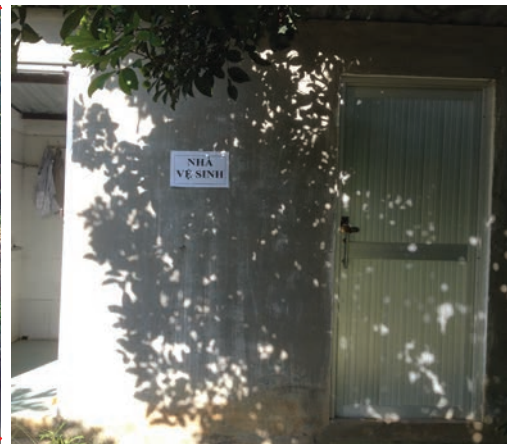
Hình 14. Nhà vệ sinh tự hoại
