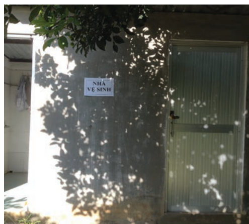
Hình 14. Nhà vệ sinh tự hoại
